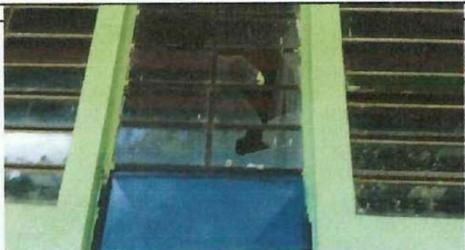
Foto 3: Se observa deterioro de techo y faltantes en el módulo.
