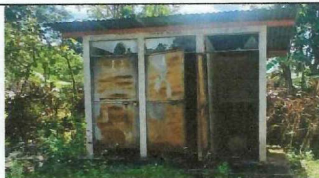
Foto 4: Se observa deterioro del techo y oxidación de las puertas de los baños.
