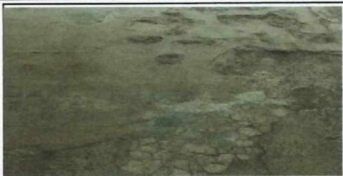
Foto 1: Se observa deterioro y fisuras en el piso de los módulos 1 y 2.
