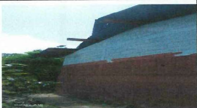
Foto 1: Se observa deterioro de techo y faltantes.
