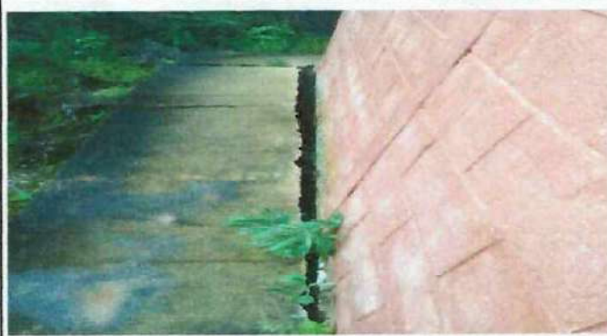
Foto 2: Se observa desliz en el pasillo.
