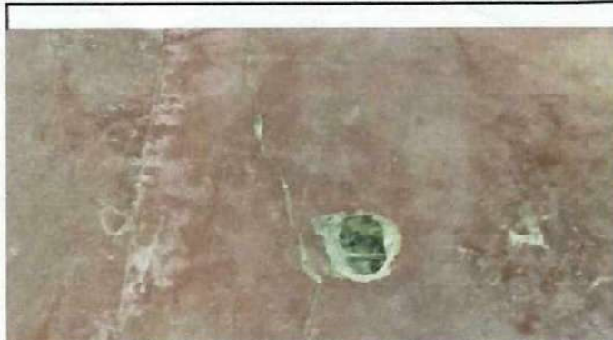
Foto 2: Se observa deterioro en el piso del aula No. 6
